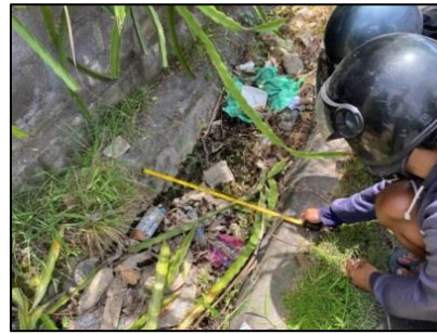
Gambar 4. Kondisi drainase dipenuhi sampah
